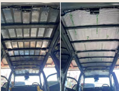
制振・断熱施工 施工箇所（フロントシート下・エンジンフード・ スライドドア・リアサイド・バックドア・天井） ¥253,000
